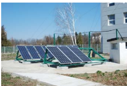
Panouri fotovoltaice pt captarea energiei solare
